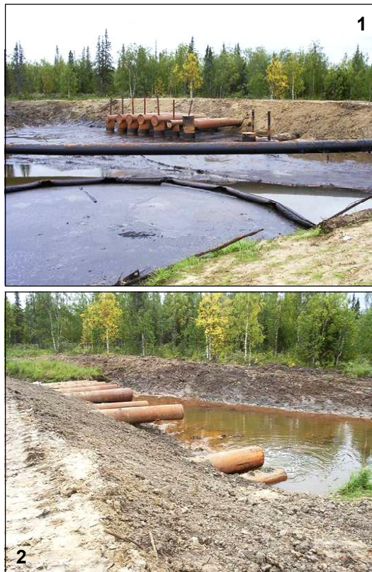
Фото 1. Гидрозатвор удерживает нефть, попавшую в водоток. В верхней части (1) сооружения (нефтеловушке) происходит накопление и сбор нефти с помощью насосов. В нижнюю часть (2) сооружения вода проходит без поверхностной нефти, но с растворенными нефтепродуктами.
