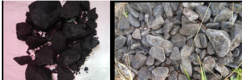
Загрязненный щебеночный балласт
