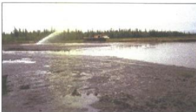
Фото 2. Проведение первичной технической рекультивации на секции 1 участка 4 «С» (смыть и локализовать поверхностную нефть, откачка нефтесодержащей жидкости вакуумбочками). Подрядчик работ ЗАО ИЭЦ «ГенЭко».
